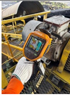
Gambar 25 Pengukuran Suhu Motor
