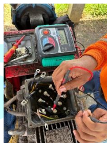
Gambar 26 Pengukuran Tahanan Isolasi Motor
